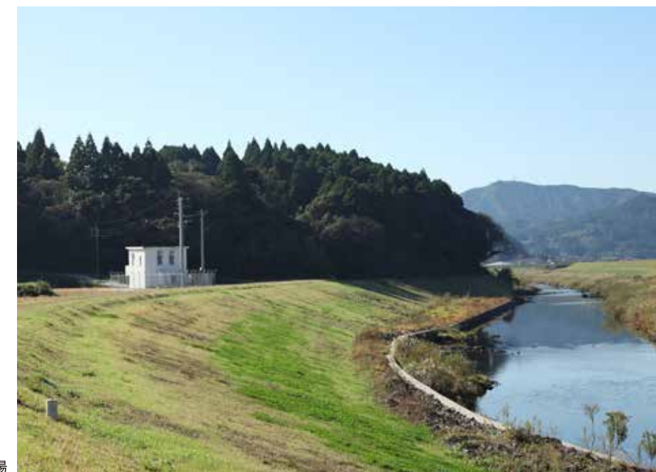
松浦川と取水ポンプ場
