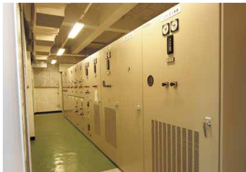
新しくなった受変電施設
