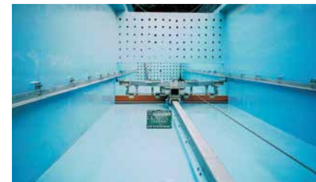
第5拡沈澱池汚泥掻寄機
