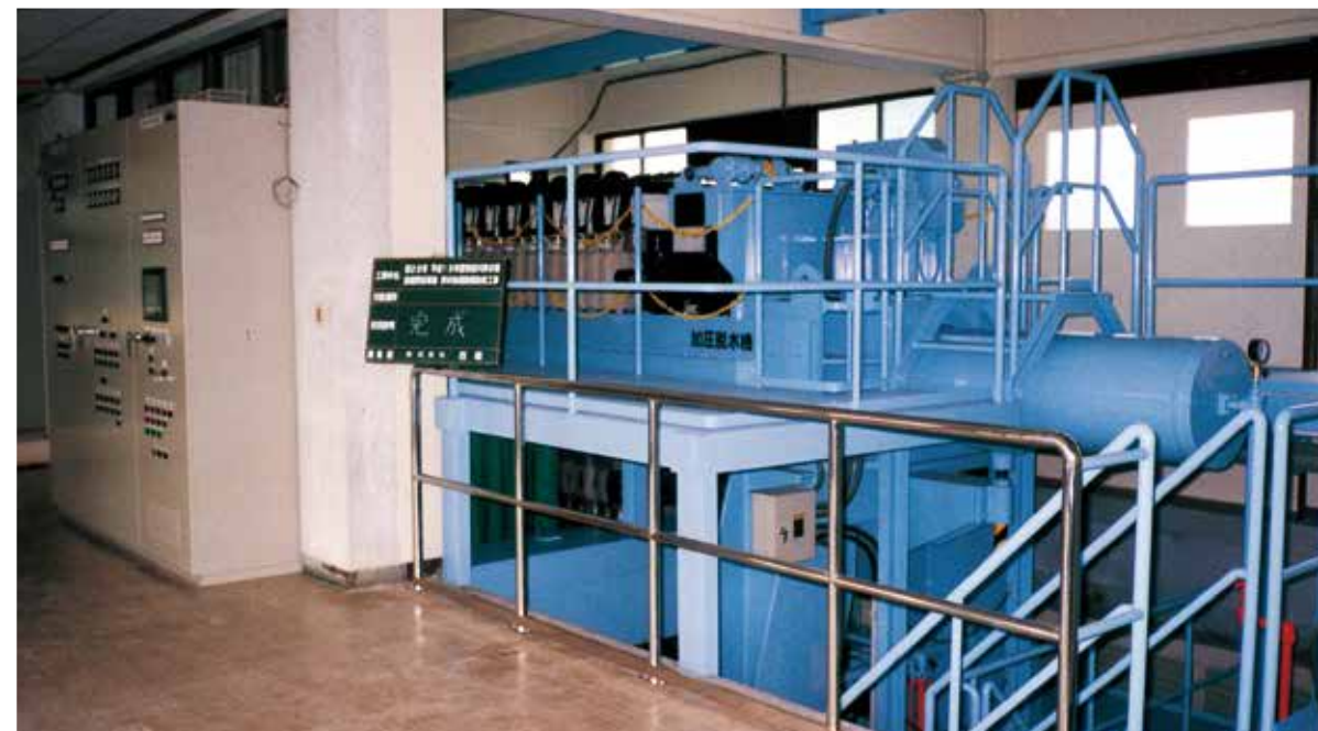
加圧脱水方式の排水処理施設
