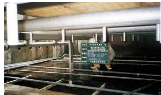
第4拡沈澱池汚泥引抜装置
