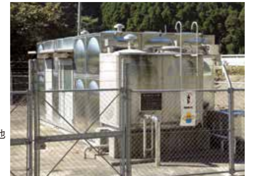
簡江送水ポンプ場
