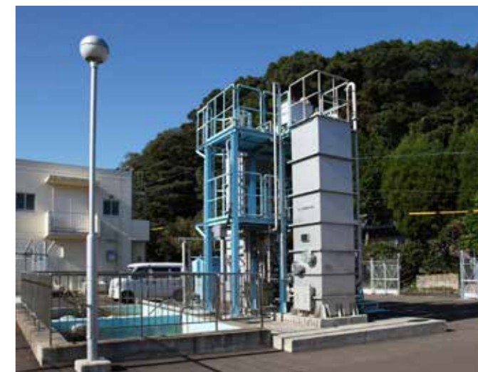
生物接触処理設備
