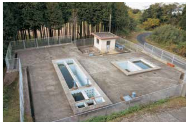
上大久保簡易水道浄水場
