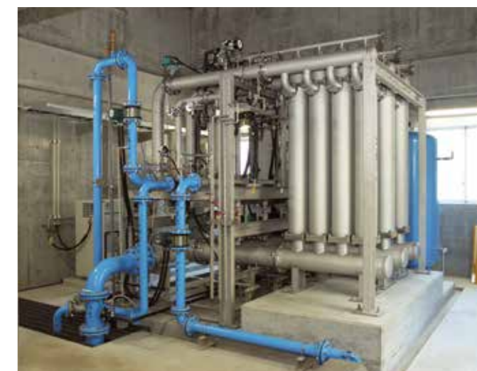
膜ろ過処理設備
