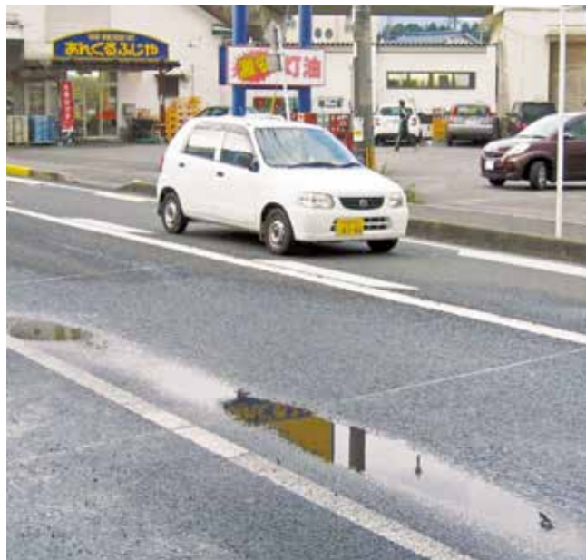
口径200mm配水管からの漏水
