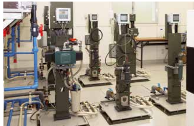
自動水質計器／残留塩素、濁度、pH値を常時監視しています。
