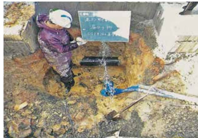
口径200mm配水管からの漏水
