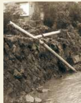
昭和42年7.9災で露出した配水管
