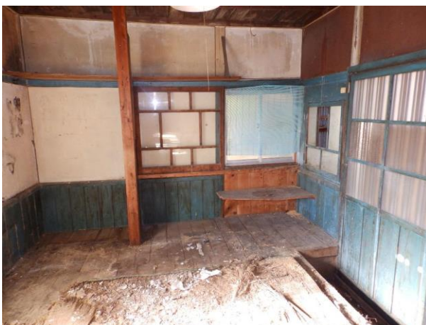
【板の間 4.5帖】腐食あり
