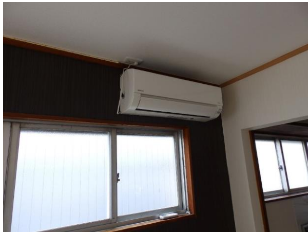
【2階 洋室エアコン】
