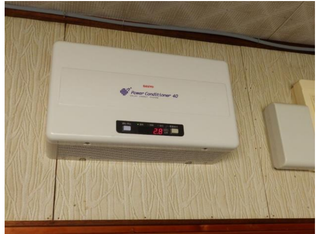
【太陽光発電設備】
