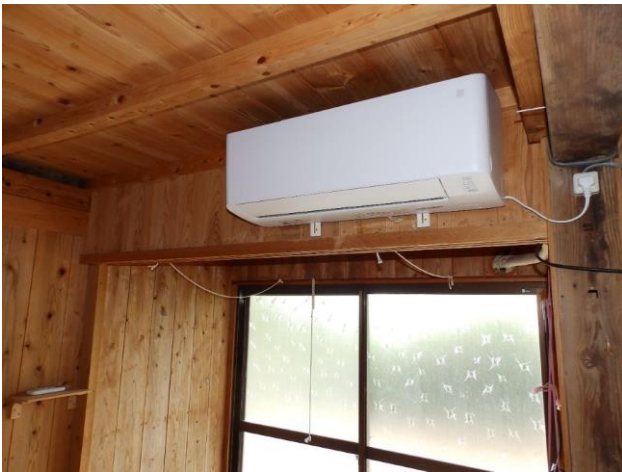
建物西側【和室エアコン】
