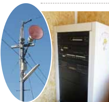
↑ 整備された屋外放送設備（一式）
