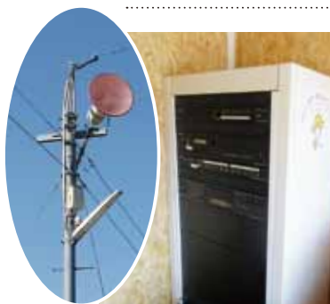
↑ 整備された屋外放送設備（一式）
