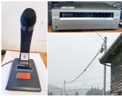
↑整備された屋外放送設備（一式）
