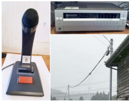
↑整備された屋外放送設備（一式）
