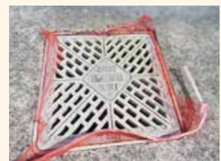
↑ 対策した雨水升
