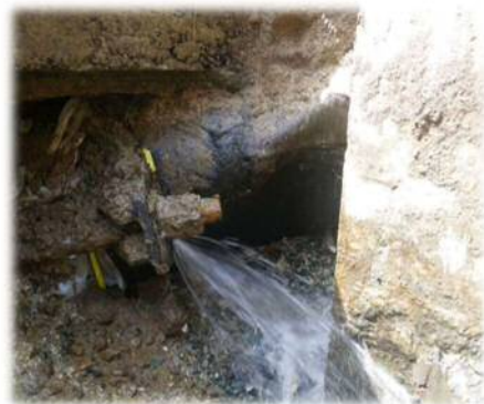
φ800 鋼管の管体破損 (上沼山津橋)
