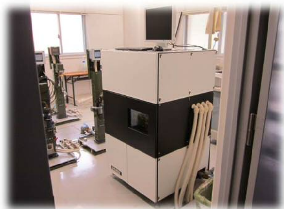
水質自動監視装置 (大川浄水場)
