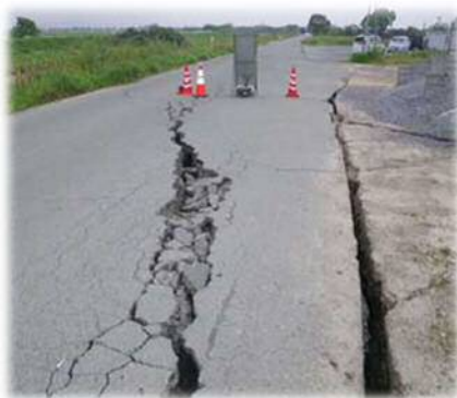
上沼山津橋左岸の地割れ
