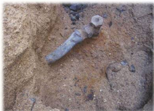
鉛製給水管 (公道上)
