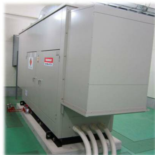
非常用発電装置 (大川浄水場 平成 22 年設置)
