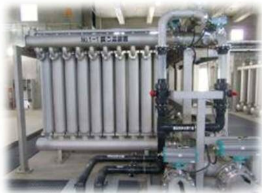
有田川浄水場（膜ろ過設備 ※2 ）
