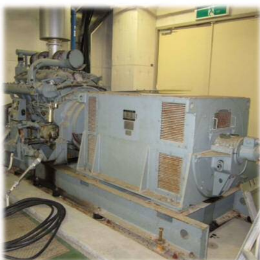
非常用発電装置 (有田川浄水場 昭和 49 年設置)
