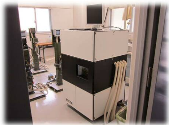
水質自動監視装置 (大川浄水場)
