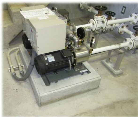
インバーター制御付加圧ポンプ（木場浄水場）
