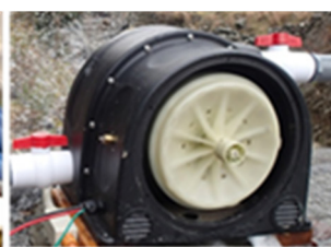
水車一体型発電機
