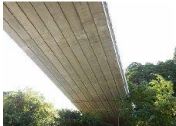
床板・下部の損傷
