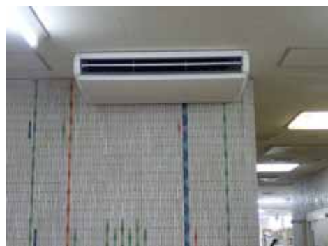
【庁舎空調設備】
