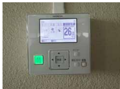
【庁舎空調設備個別スイッチ】
