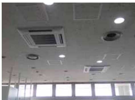
【庁舎空調設備】
