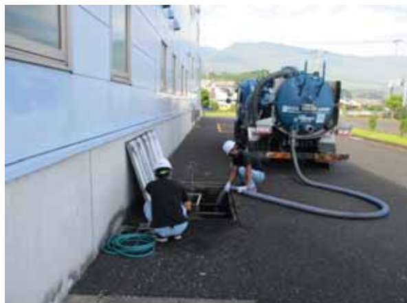
【維持管理業務】 (排水処理設備点検・清掃業務)
