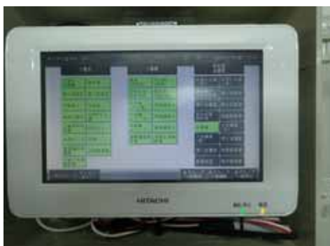
【庁舎空調設備集中管理システム】
