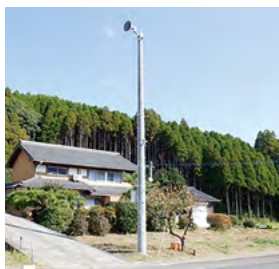
↑真手野区で整備した屋外無線放送設備の一部
