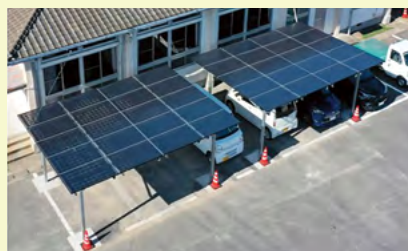
↑二里コミュニティセンターに設置している太陽光パネル
