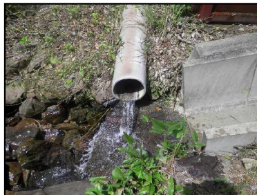
O08 : 排水タンク流出水
