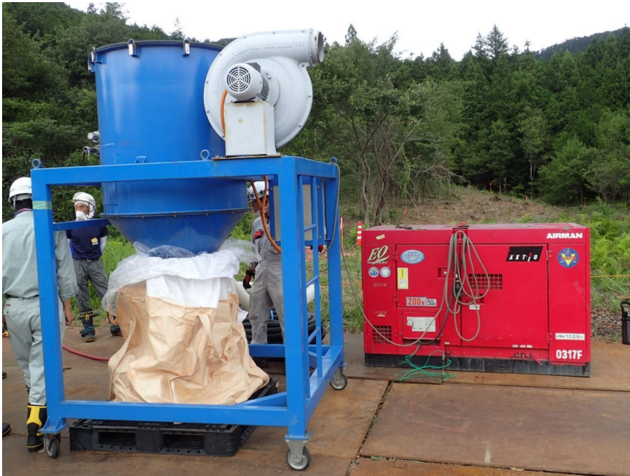
1) コンプレッサー(右側)と集粉機(左側、ジェクロン)
