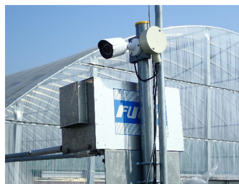
防犯カメラの設置
