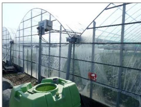
防犯カメラの設置
