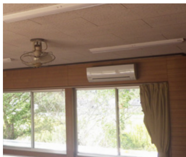
↑新しく整備した空調設備
