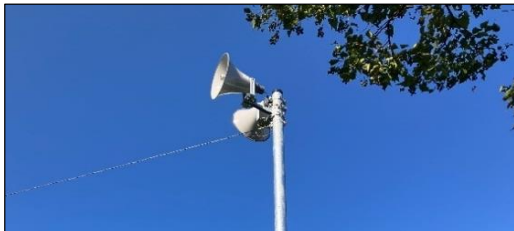
楠久津区の放送設備
