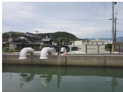
市が設置した2基の強制排水ポンプ
