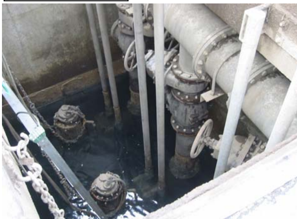
ポンプ室内部
