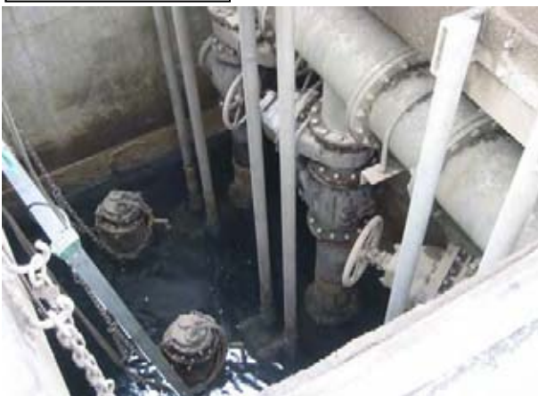
ポンプ室内部
