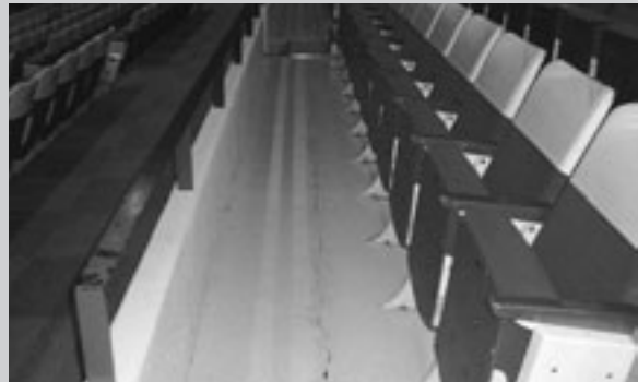
地震による亀裂(市民会館客席の床)
