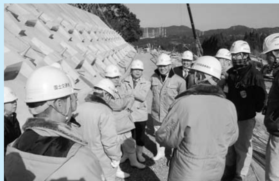
平成29年度完成予定である南波多谷口ICから伊万里東府招IC間の地滑り対策工事現場
