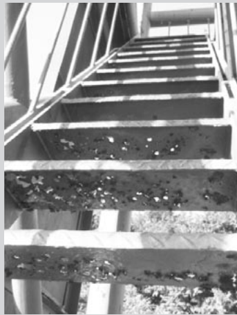
腐食した階段
