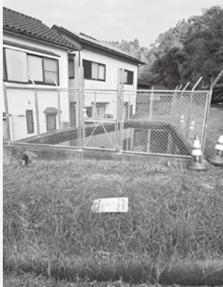
改修された木須西区の防火水槽
