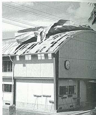
◎台風ではがれた体育館の屋根
