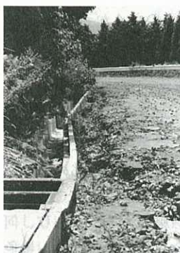
○（大曲大野岳原屋敷線で）雨水でえぐられた路面
