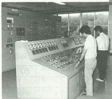
◎浄水場の中央監視室
