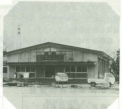
▲大坪公民館建設 3月20日竣工を前に最後の仕上げをしています。(2/21撮影)
