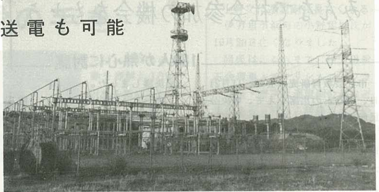
▶ 北部九州の都市へ送電している西九州系統開閉所◀
