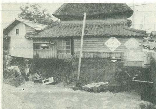
護岸が落ち、床下をえぐり取った濁流（東円造寺・中島橋横の住家）
