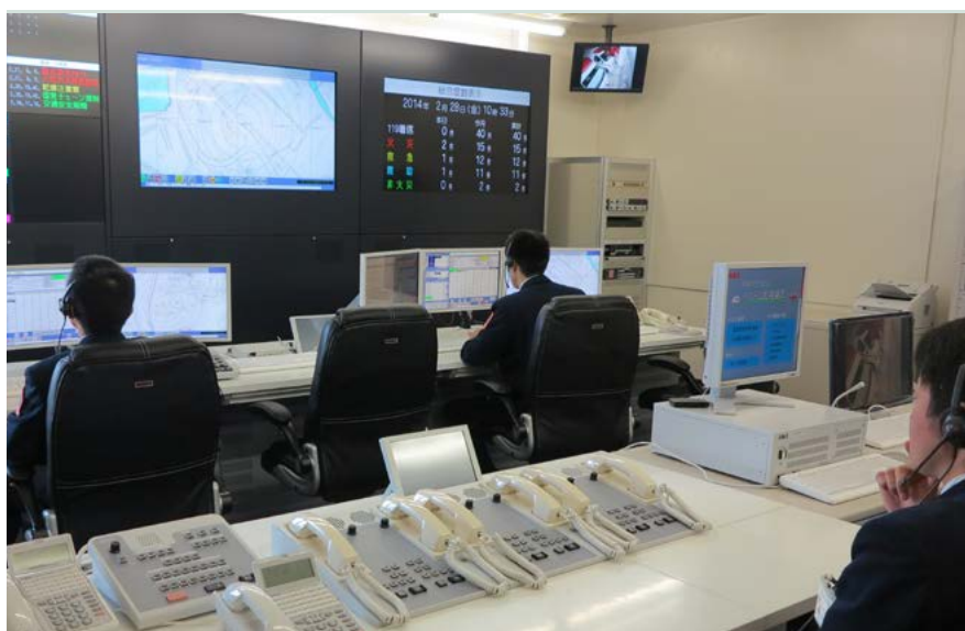
↑今回整備した高機能消防指令システムです。皆さんのより安心して安全な暮らしのため、今後役立てていきます
